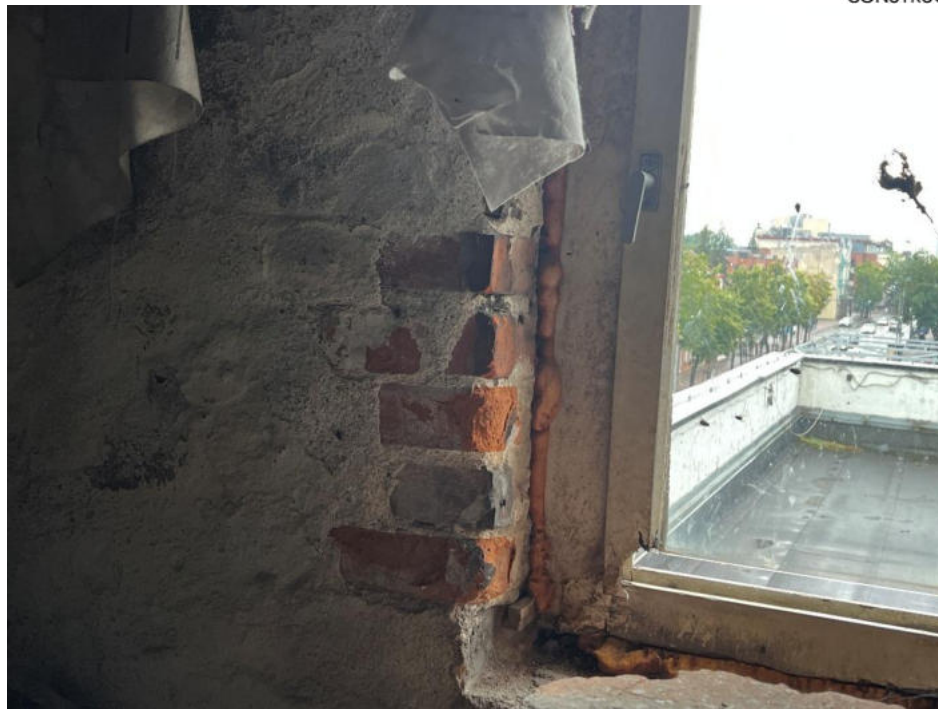
71 pav. Nuplėšta stogo difuzinė plėvelės greta mūro sienos fragmentas
