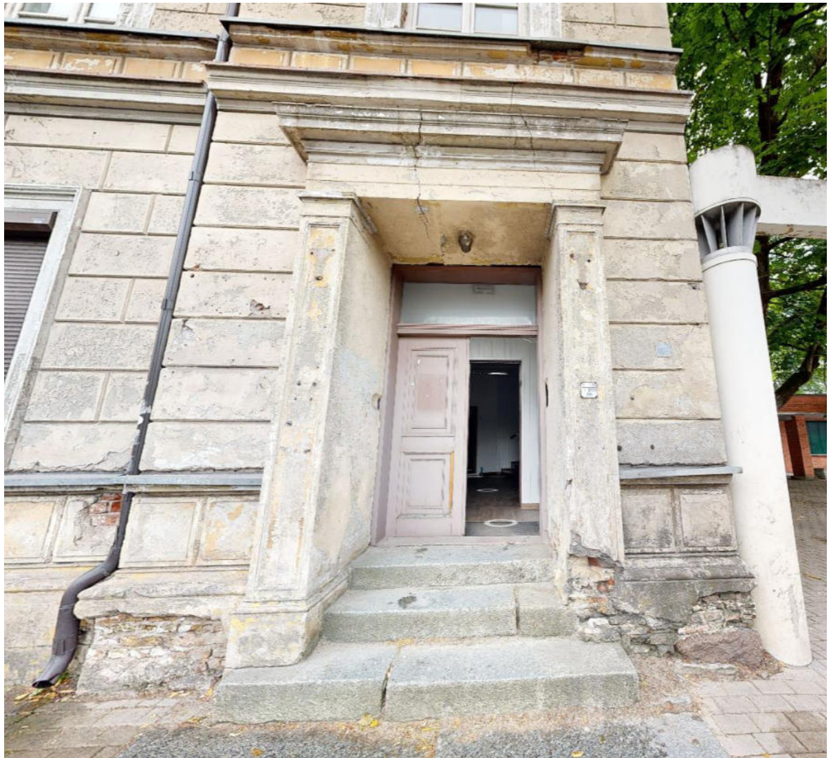
21 pav. Virš įėjimo atsiradusių pažeidimų fotografacija
