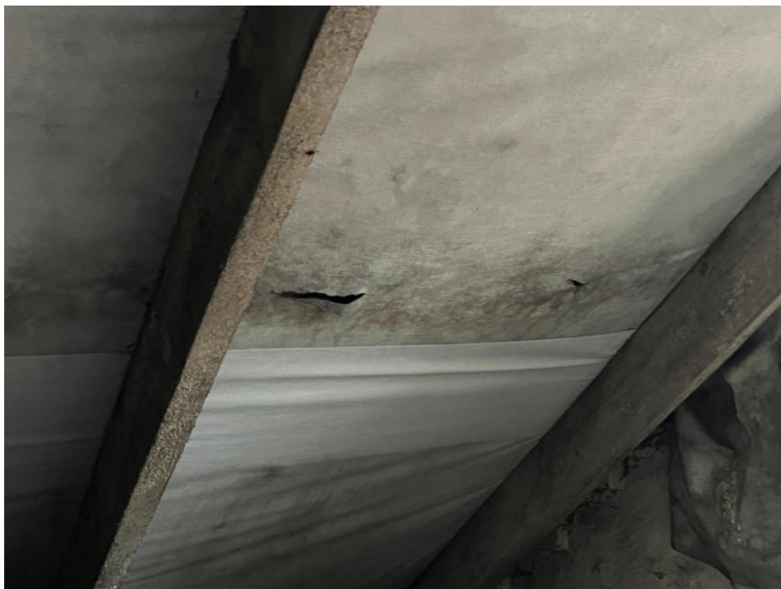
69 pav. Pažeista stogo difuzinė plėvelė
